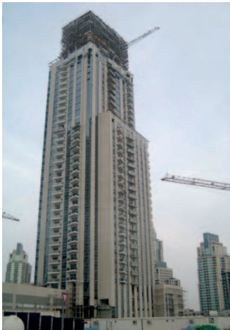
Denne beboelsesejendom i Dubai Marina er beklædt med ca. 20.000 m 2 vægpaneler. Overfladen er hvid beton med fritlagte hvide sten.
